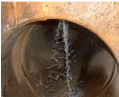
Grundwassereintritt (undichte Fuge).
