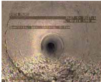
Innenkorrosion mit Querriss.
